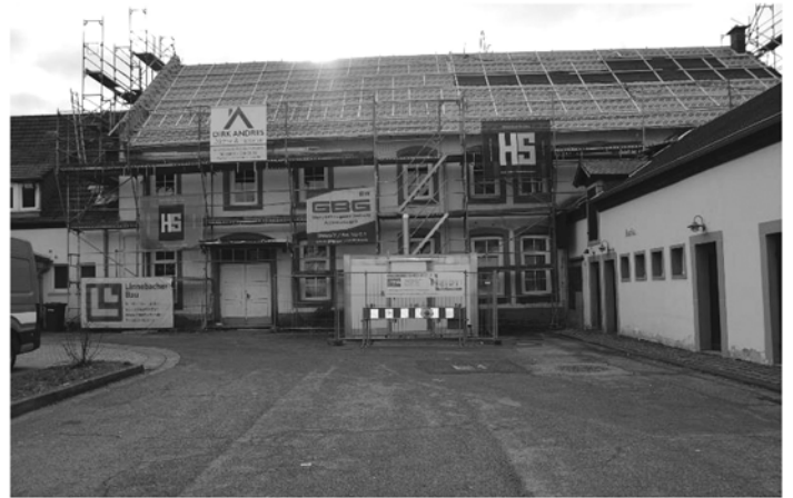
Frontansicht des Gebäudes mit der aufgestellten Bauheizung
